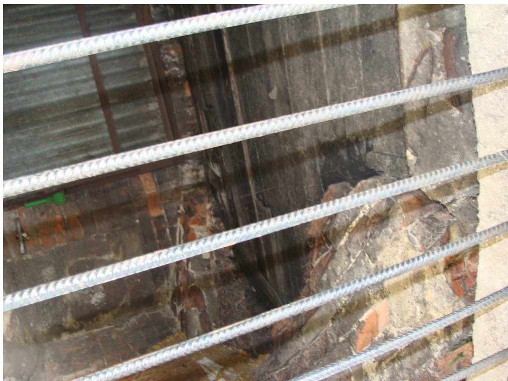
Zdjęcie. 4 – Widok płyty żelbetowej nad tarasem B i zawalony strop ceramiczny
