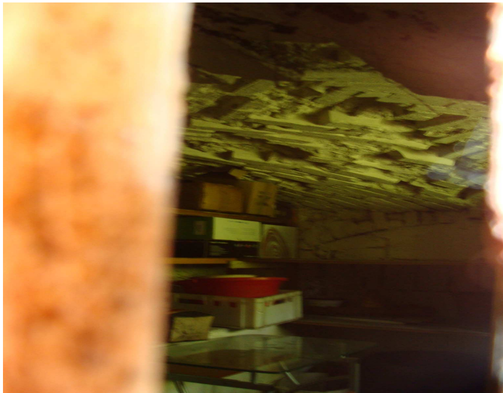
Zdjęcie. 5 – Zawalony strop ceramiczny nad tarasem B
