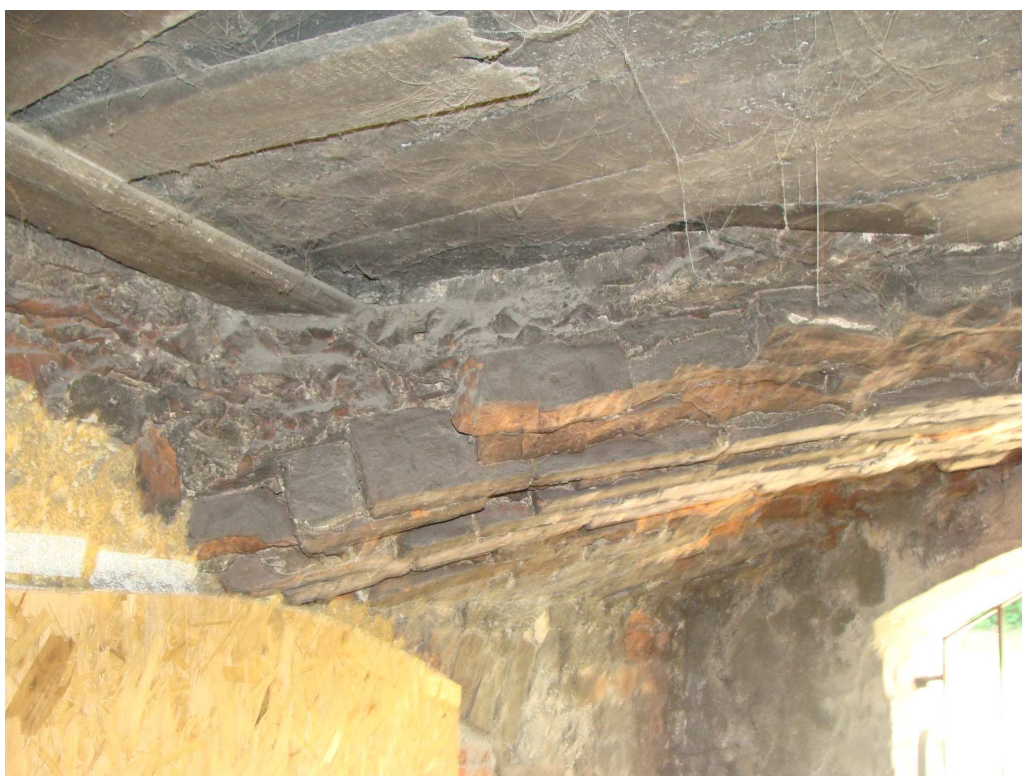
Zdjęcie. 6 – Widok płyty żelbetowej nad tarasem B i zawalony strop
